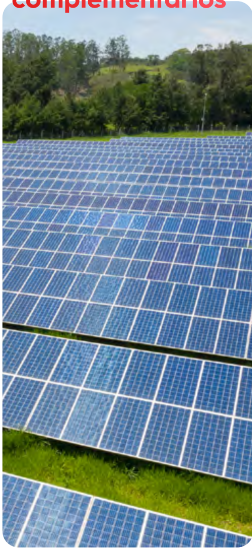
Paneles de energía en Hacienda Solar.
